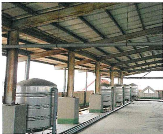
東西棟頂樓各裝設 5 座 4000 公升水塔收集雨水
