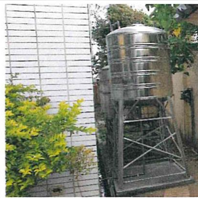
東棟一樓裝設 2 座 2000 公升水塔收集雨水
